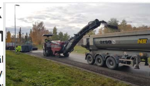
Asfalten på ett omkring ett 100 meter långt vägvagnsgräv har rivits upp och vägen måste läggas om, uppger Trafikverket. Foto: Calle Elfström/SVT
